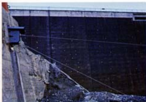
Fig. 67 - Paramento metallico della diga a gravità dell'Alpe di Gera (impianto idroelettrico del Mallero, dell'ENEL). In primo piano si notano le funi metalliche, tese trasversalmente al bacino, che fungono da anodi per il sistema di protezione catodica a corrente impressa, realizzato dal CISE.
