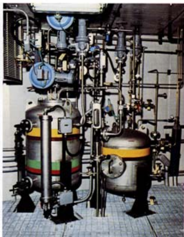
Fig. 45 - Impianto CART-TC (v. fig. 42): serbatoio di espansione (a sinistra), serbatoio tampone dell'elio (a destra).
